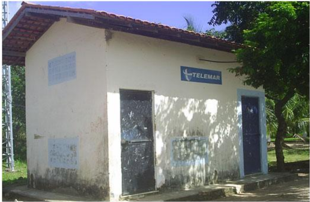
Figura 2.91 Central de telefonia da Oi (antiga Telemar) na Vila de Fortalezinha. Fonte: SEMA (2007)
